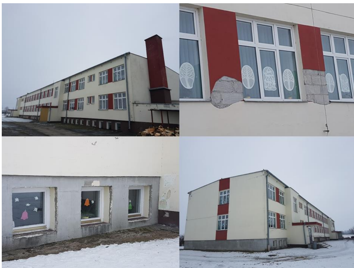
RYSUNEK 23. DOKUMENTACJA FOTOGRAFICZNA - STAN TECHNICZNY BUDYNKU SZKOŁY W CZERNICACH BOROWYCH
