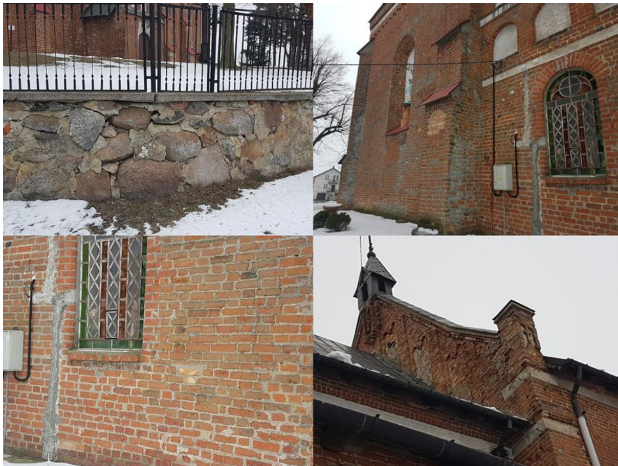
RYSUNEK 21. DOKUMENTACJA FOTOGRAFICZNA - STAN TECHNICZNY KOŚCIOŁA W CZERNICACH BOROWYCH
